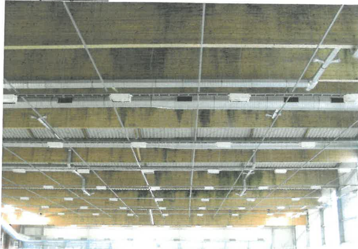
Fot. 1. Widok ogólny dźwigarów porażonych biokorozją.
